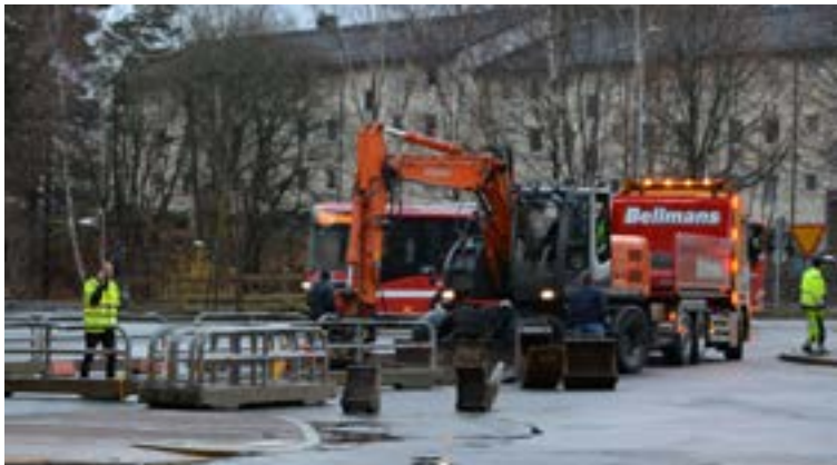
Söndagens bussproblem i Tyresö centrum handlade enligt personal på plats om ett avloppsstopp orsakat av att svaveloxider bildats i avloppstunnlarna vilket fräter på betongen och orsakar kollaps av rören.
