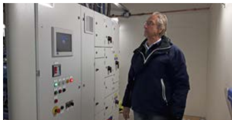
Björn Hellqvist visar nya kylmaskinen som monterats i Finland, finns i dag i ett nybyggt maskinrum. FOTO: TYRESÖ NYHETER
